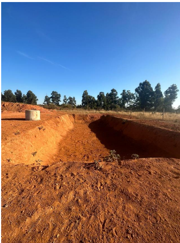
FOTO 2: LAGOA DE CONTENÇÃO
