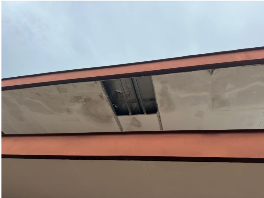
Foto 5: Deslocamentos e Manchas de Umidade
