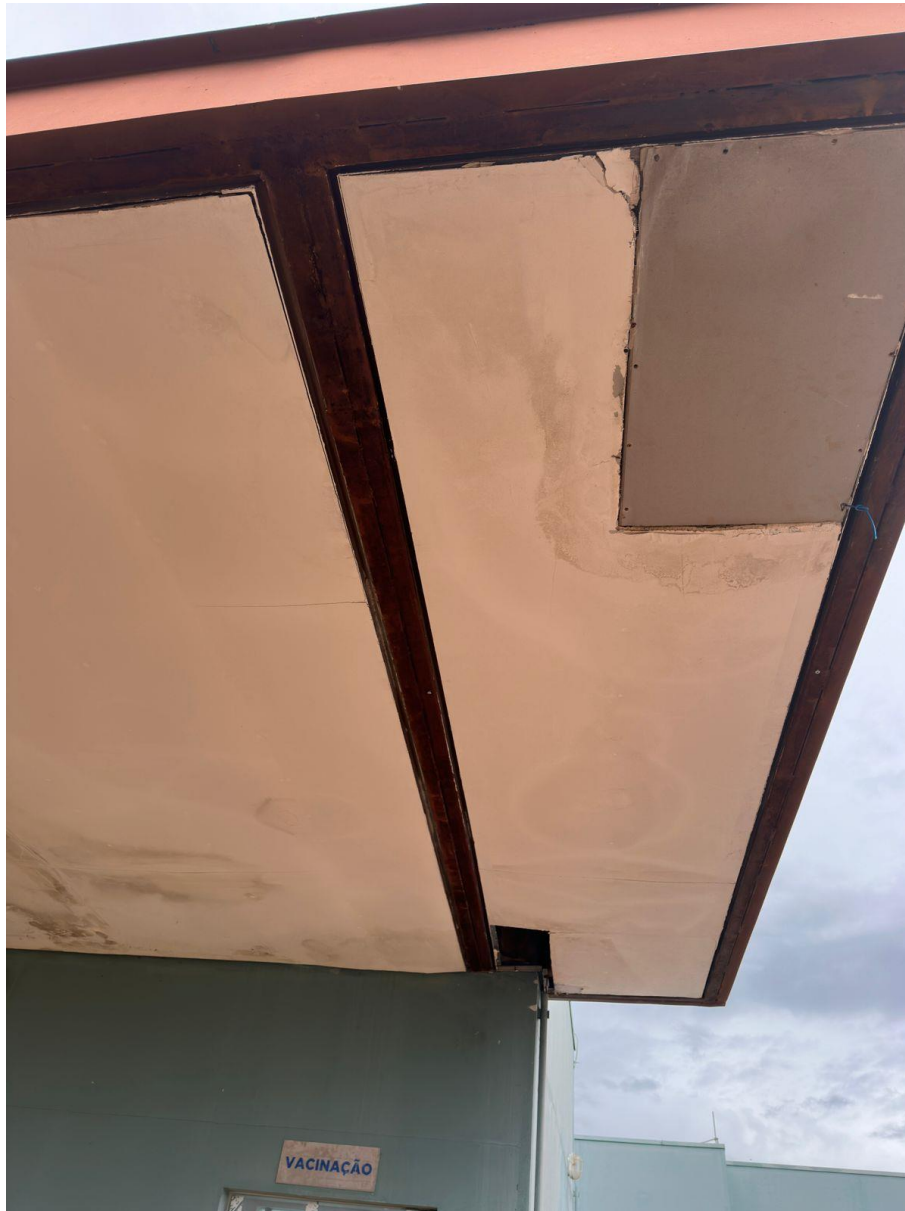
Foto 3: Deslocamento de Peças de Forro
