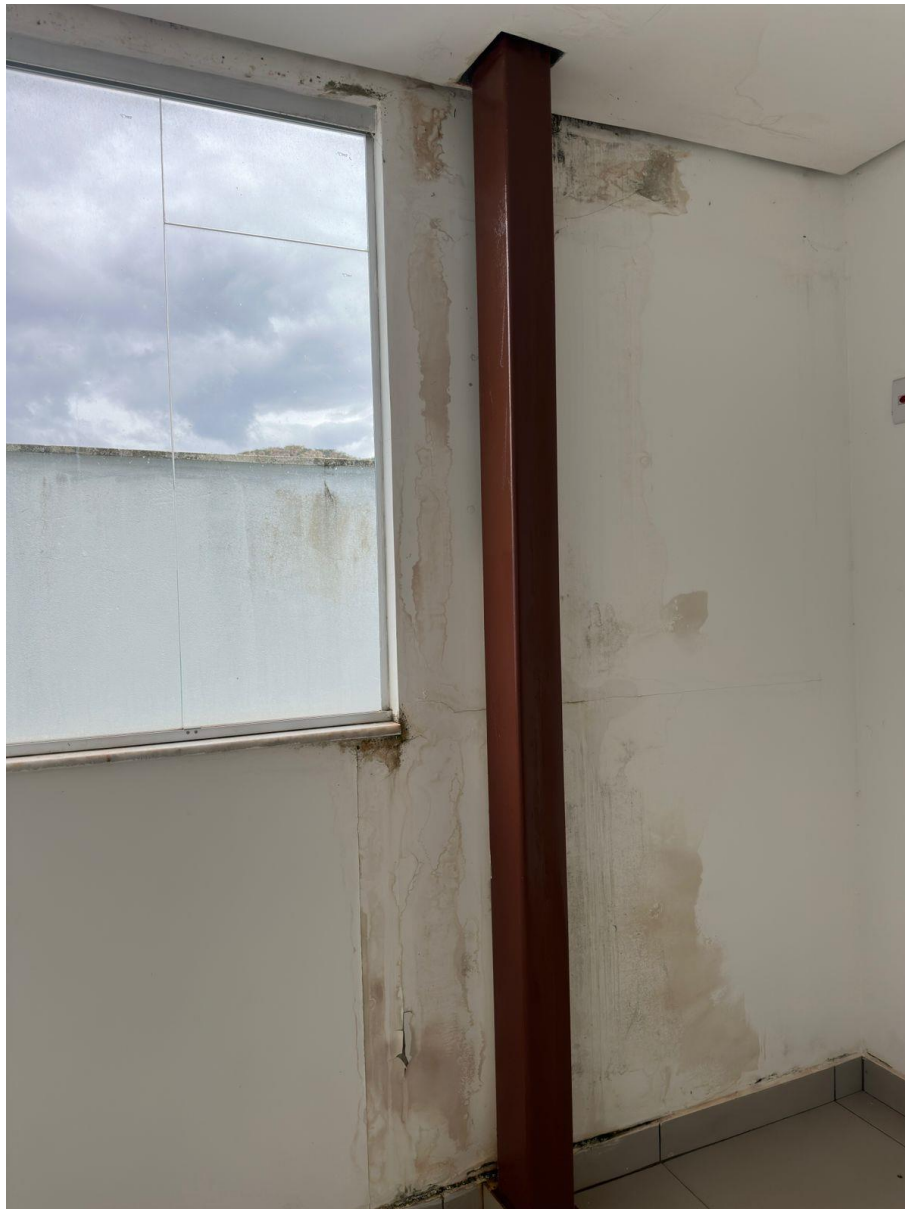
Foto 1: Presença de Umidade
