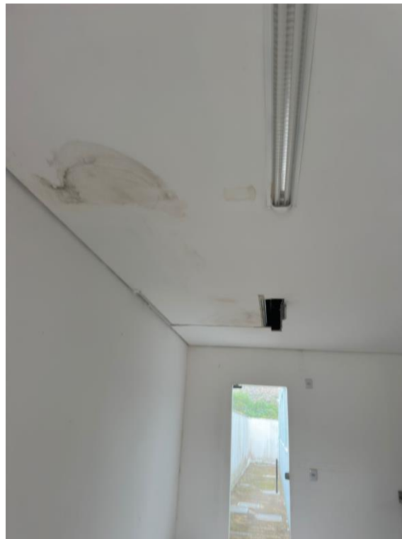
Foto 6: Deslocamentos e Manchas de Umidade.
