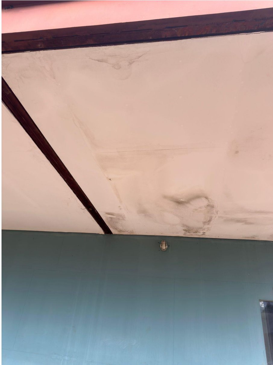
Foto 4: Manchas Decorrentes de Umidade
