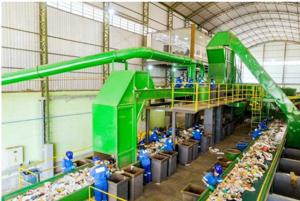
Figura 5 – Modelo de Usina de Triagem mecanizada – UTM
